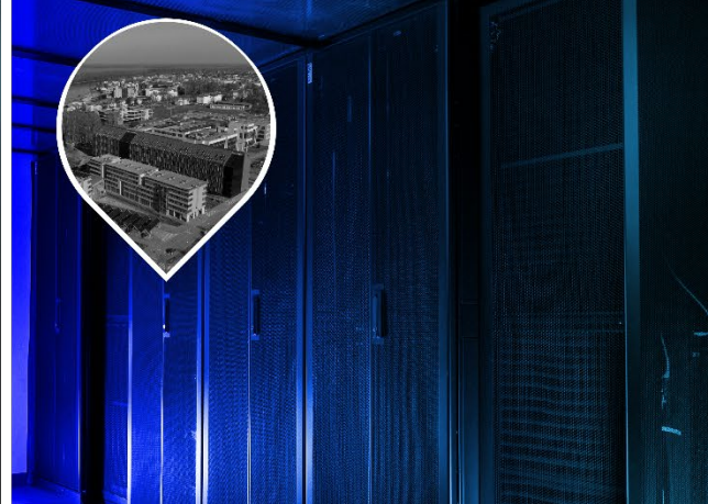
Podatkovni centar u Osijeku HR-ZOO OS 📍 Sveučilište J. J. Strossmayera u Osijeku, Sveučilišni kampus Osijek
